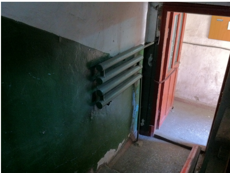
Радиатор в подъезде
