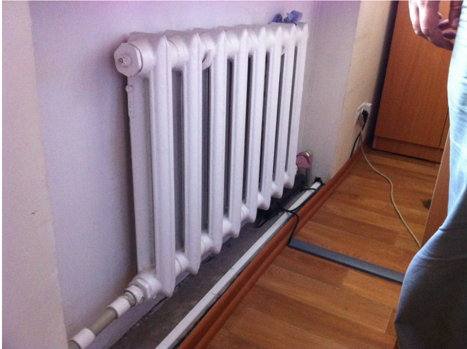
Радиатор с обновлённым соединением с однотрубной системой – отсутствие термостата и замыкающего участка (краткого соединения)
