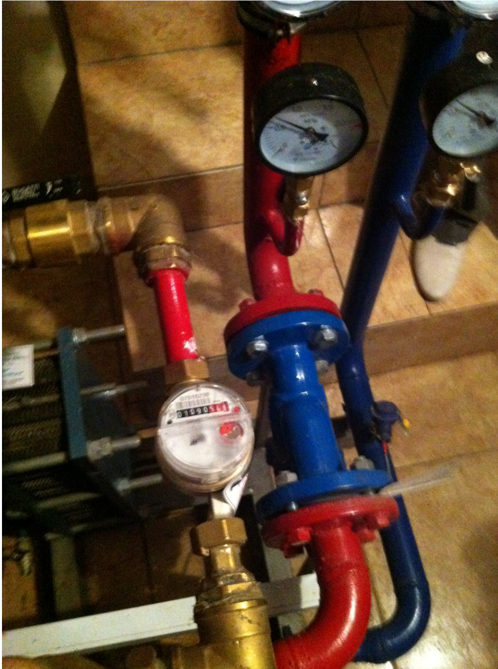
Новый центральный тепловой пункт с приборами учёта тепла
