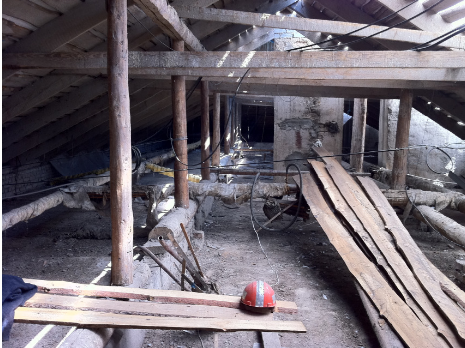
Чердачное помещение / крыша с деревянной конструкцией / трубы отопления с недостаточной изоляцией
