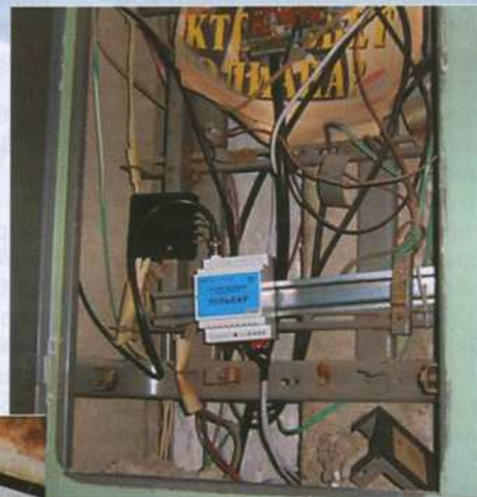
Рис. 2 Установка этажного модуля «РадиоПульсар»
