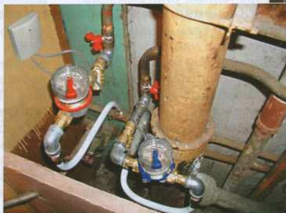
Рис. 1 Установка квартирного модуля «РадиоПульсар»
